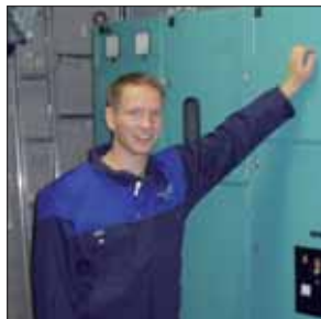
Tero Toivonen huoltoteknikko/ED puh. 010 446 615 tero.toivonen @fi.schneider-electric.com
